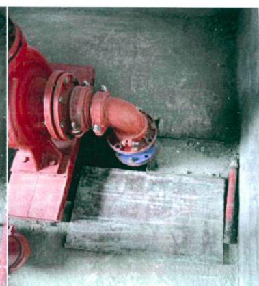
整改后：孔洞已封堵密实
