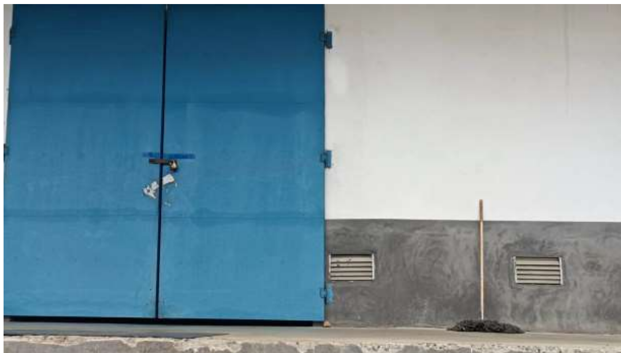
20号成品库未配备灭火器
