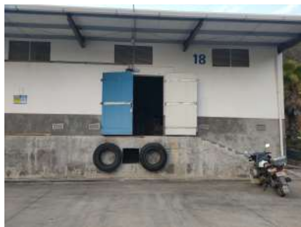
18#成品库未配备灭火器
